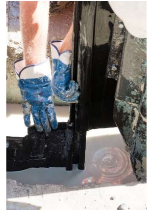
Enclenchement des serrures PEHD
